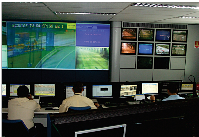
Figura 3: Central de monitoramento
